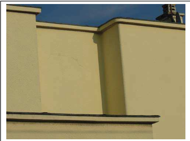
Détail du retrait situé au niveau de la porte d'entrée à R + 1 (8 rue M. Croxo)
