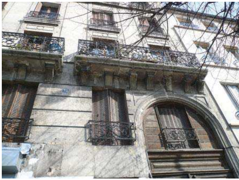
Ci-dessus, détails de la ferronnerie et de la modénature. Ci-contre la porte cochère et la baie d'entresol encadré de lambris. Département de la Seine-Saint-Denis, DCPSL, SPC
