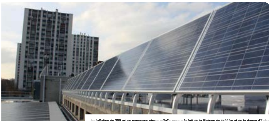
Installation de 200 m 2 de panneaux photovoltaïques sur le toit de la Maison du théâtre et de la danse d'Épinay
