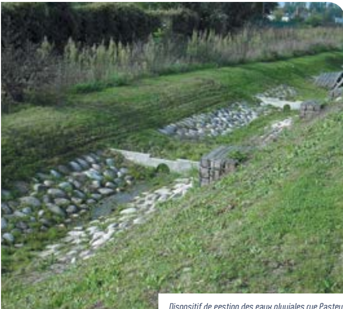
Dispositif de gestion des eaux pluviales rue Pasteur à Uilletaneuse
